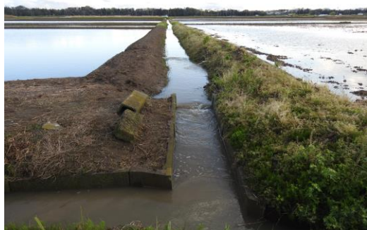
写真2. 増水し配水管から侵入
